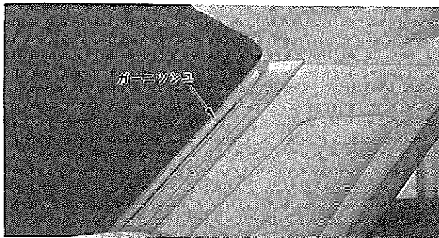
室内側サイド ベンチレーション
